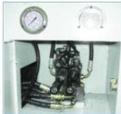
Einstellung / Überwachung des Spanndruckes
